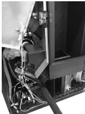
Fig. 72 - Room fan cleaning
