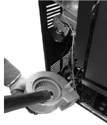
Fig. 74 - Room fan cleaning
